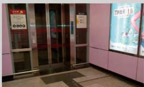
銅鑼灣港鐵站 - 防火地板門
