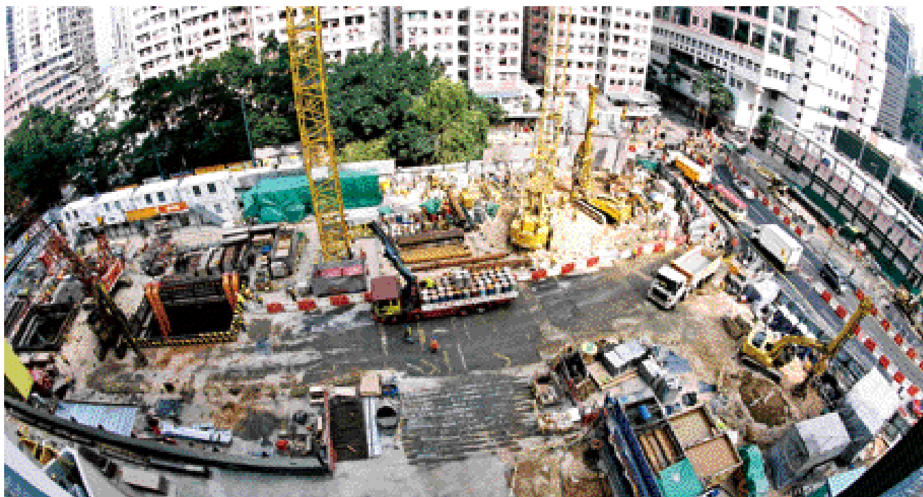
科士街工地正進行掘挖及安裝隔音層板的工程，以建造堅尼地城站
